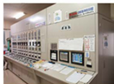
中央コントロールルーム 醸（もろみ）タンク1本ごとの温度・湿度を 自動的に管理
